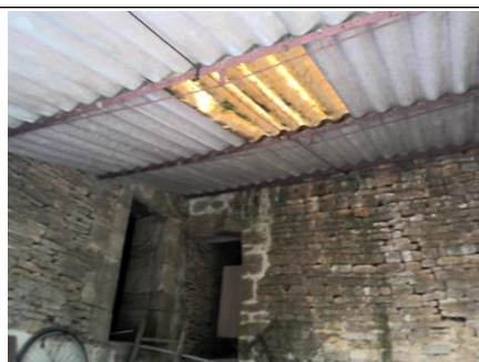
Photo n° PhA001 Localisation : Rez de chaussée - Appentis 2 Ouvrage : 1. Toiture et étanchéité - Plaques ondulées Partie d'ouvrage : Plaques en fibres-ciment Description : Plaques en fibres-ciment Localisation sur croquis : M001
