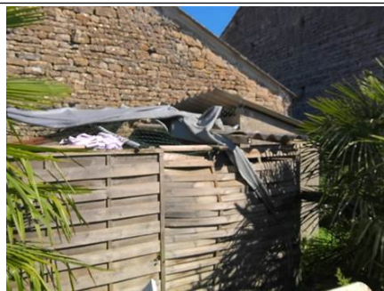
Photo n° PhA004 Localisation : Rez de chaussée - Chenil Ouvrage : 1. Toiture et étanchéité - Plaques ondulées Partie d'ouvrage : Plaques en fibres-ciment Description : Plaques en fibres-ciment Localisation sur croquis : M004
